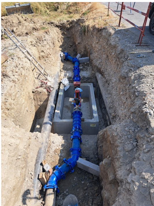
Regard de réduction à Lompraz (La Balme)
