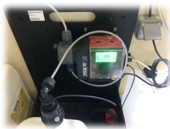
Pompe doseuse de chlore
