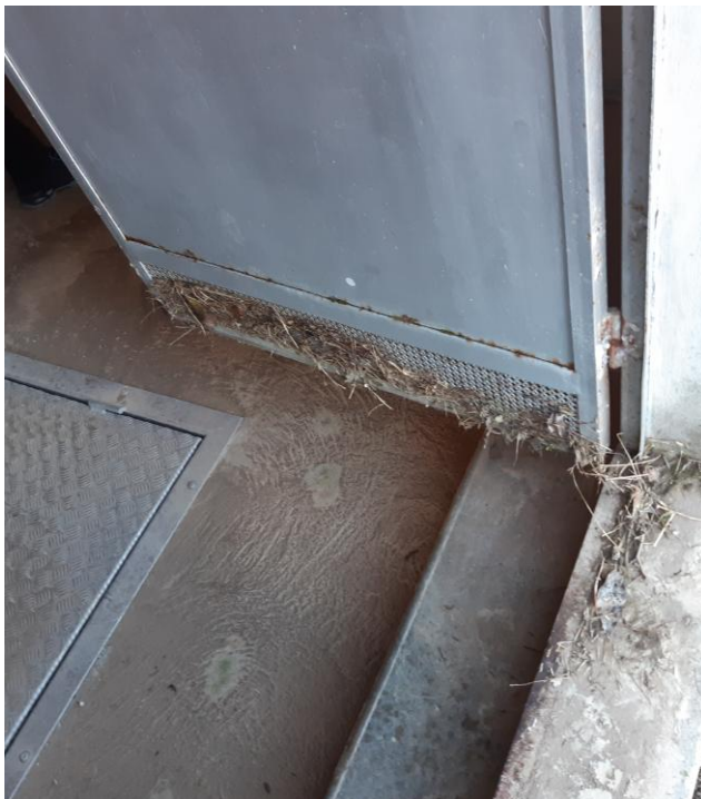
Laisses de crue et boue à l'entrée de la station de pompage de Nangerat
