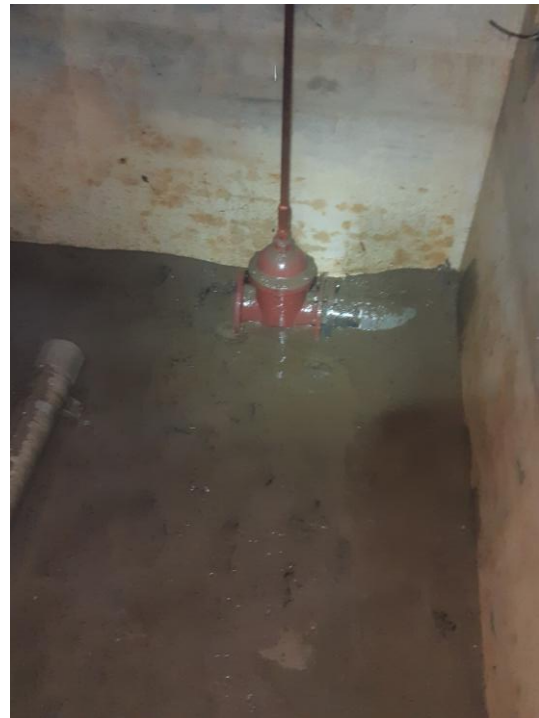
Boue dans la bache de la station de pompage
