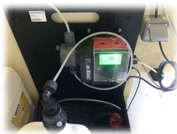
Pompe doseuse de chlore
