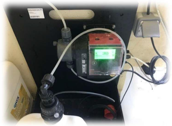
Pompe doseuse de chlore
